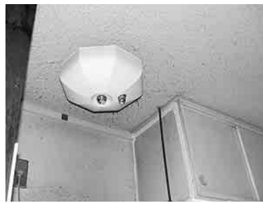
天井に取り付けた簡易自動消火装置
